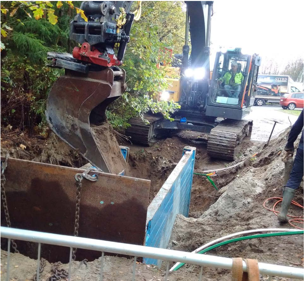
Illustration 10. Schaktsäkring av schakt 3-6, för att kunna gå ned djupare utan att schaktkanterna rasar in. Foto mot syd.
