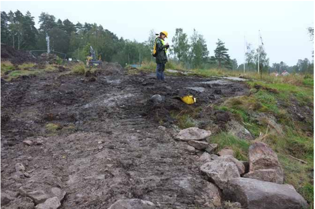
Illustration 27. Linda mäter in den skadade skärvstenspackningen, anläggning 8 i sektion 28. Foto mot norr.
