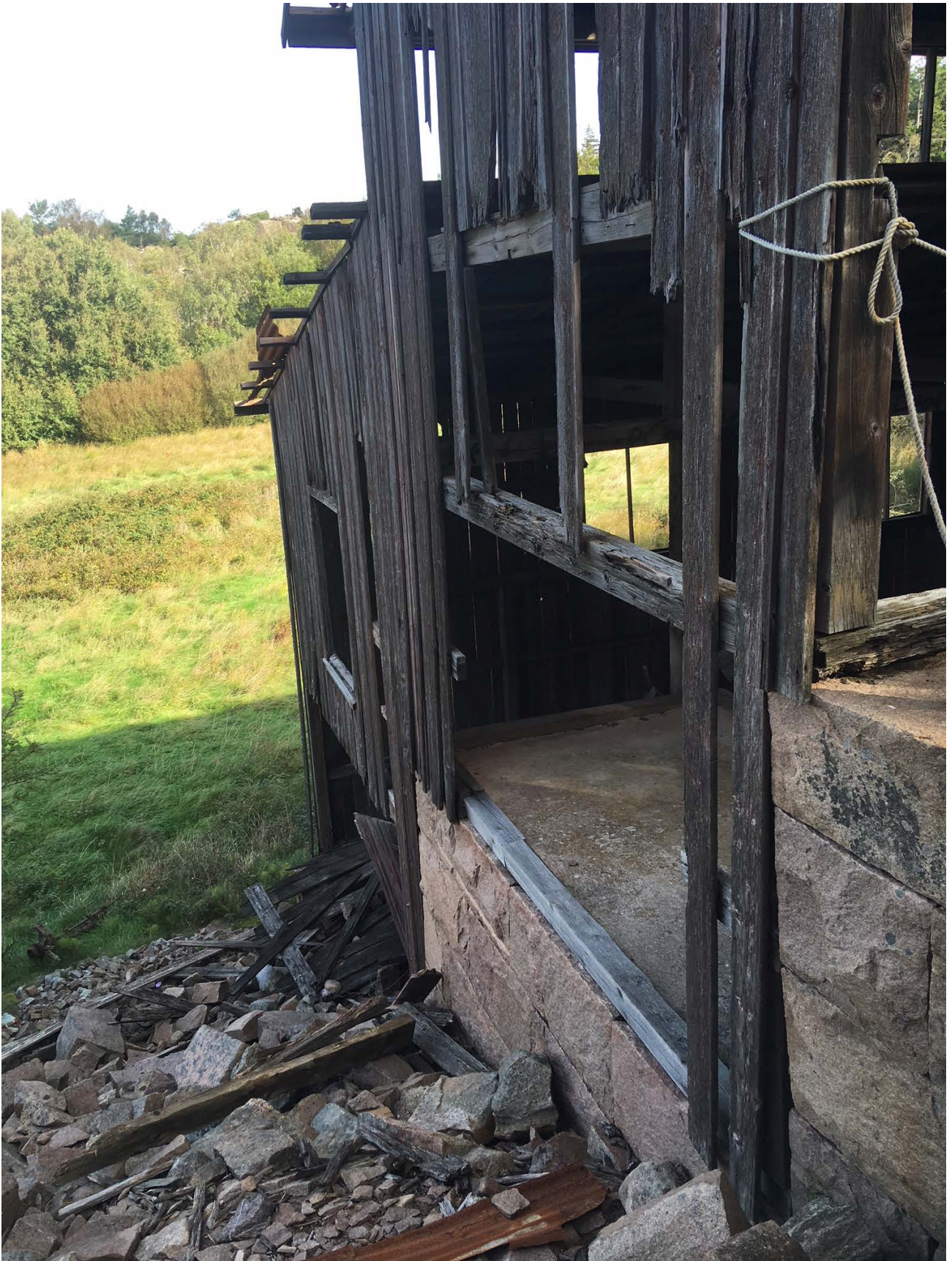
Bild 7. Rötskadade bärande delar i västra gaveln. Panelen var mycket illa åtgången av väder och vind.
