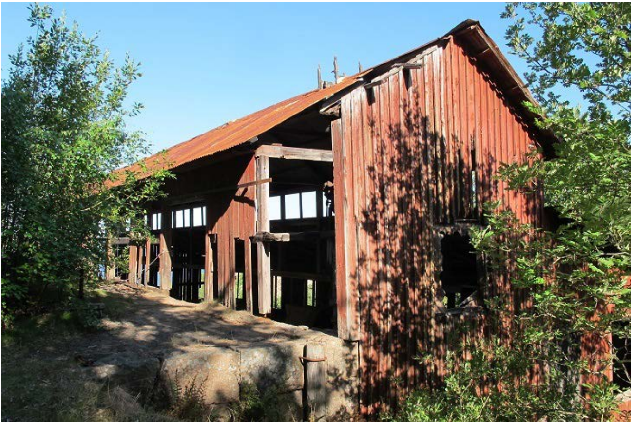
Bild 2. Östra gaveln samt södra långsidan. Taktäckning saknades vid sydöstra hörnet vilket gjorde att bärande delar av gaveln var rötskadade samt gett upphov till skador på takstol. Syllen längs södra långsidan var direkt i marknivå och takavvattning saknades vilket gett upphov till rötskador.
