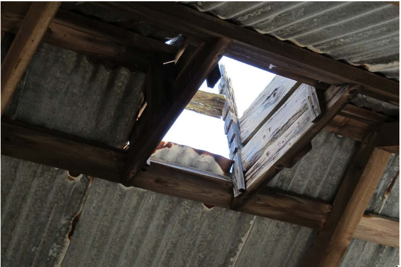
Bild 4. Vatten trängde in kring hålen för takryttarna vilket skadade konstruktionen och den kvarvarande spaltmaskinen.
